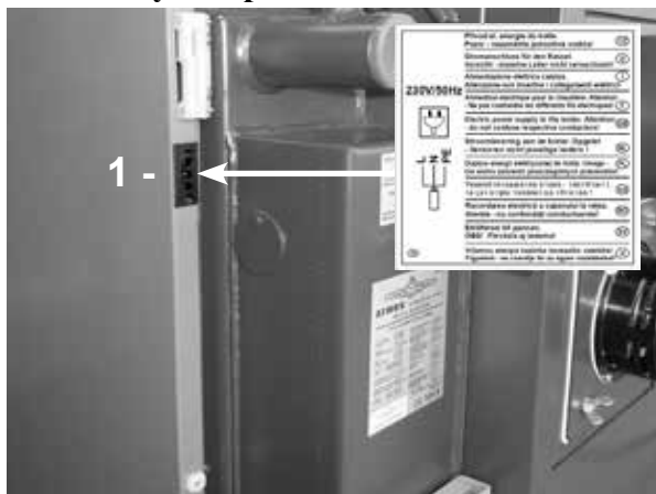
Konektor v pravé kapotě kotle
