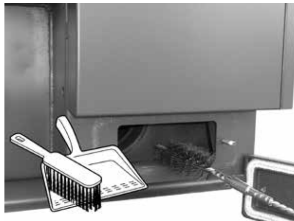
Ukázka čištění kouřového kanálu - spodní víčko
