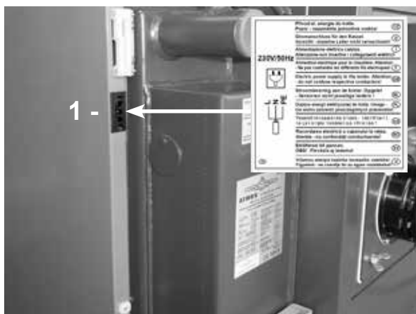
Konektor v pravé kapotě kotle
